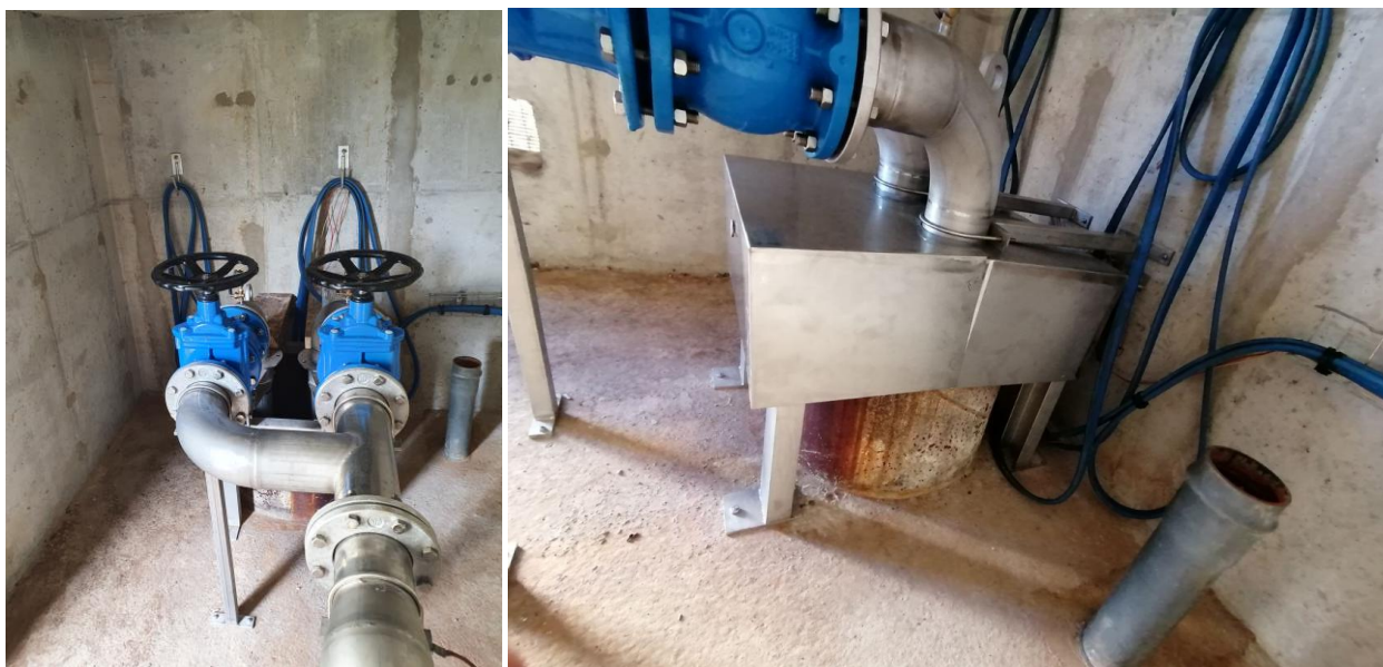
Figure 12 – Tête de puits et capotage de protection amovible sur châssis inox indépendant
