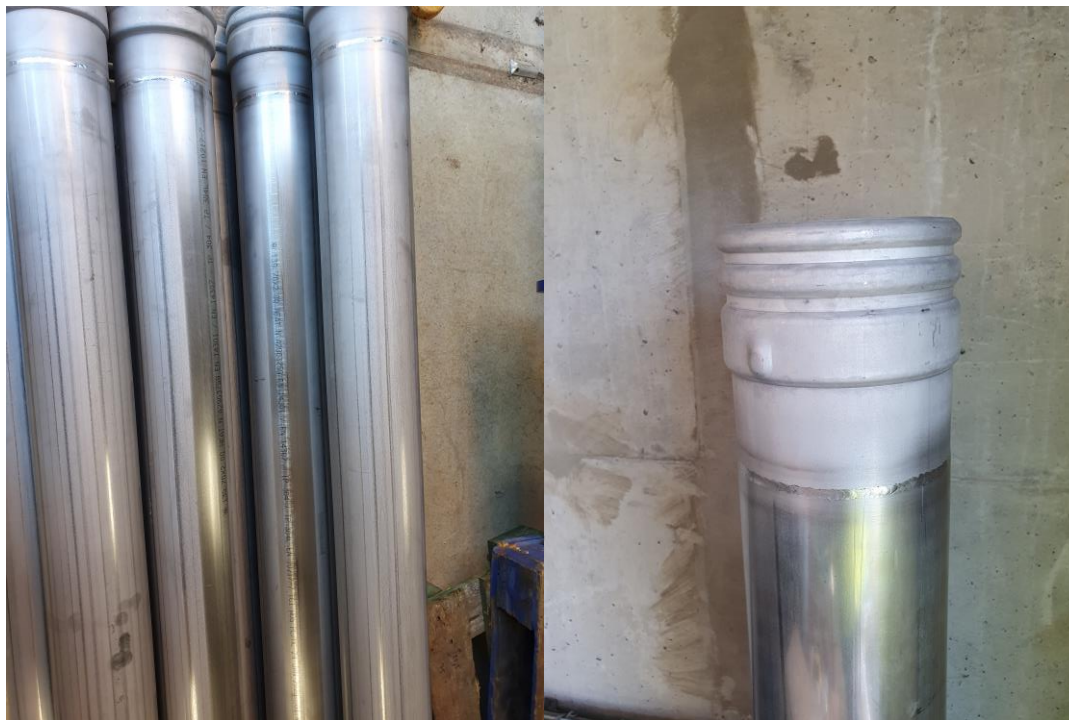
Figure 11 – Nouvelles colonnes d'exhaure DN 150 et détail des connexions type « ZSM »
